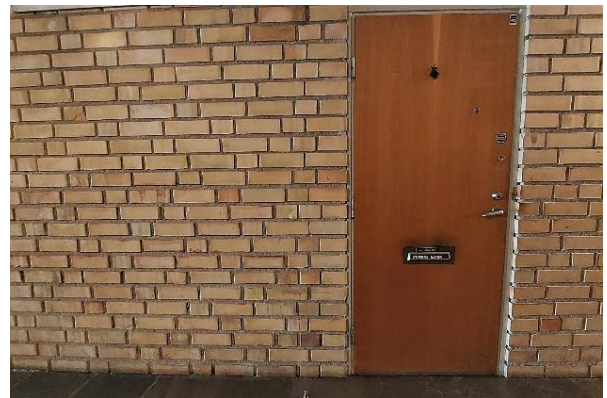
Lägenhetsdörr infälld i tegelväggen utan foder.
